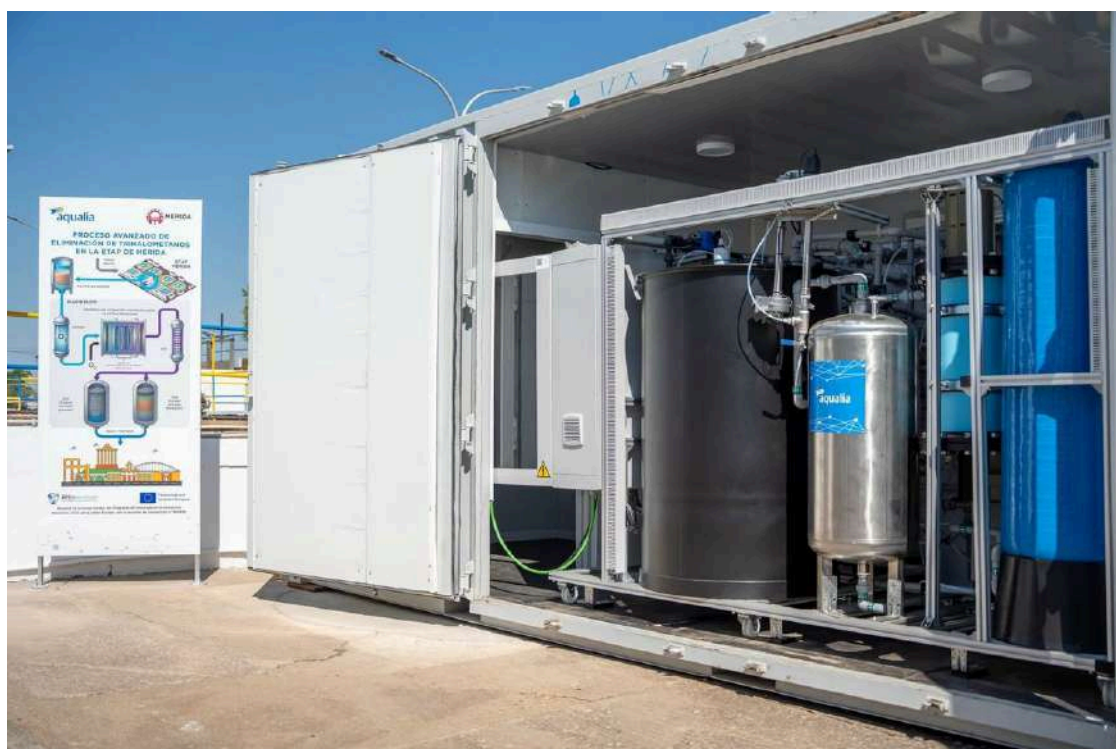
La modernización de la potabilizadora de Mérida incorpora nuevos sistemas para reducir los trihalometanos y reforzar la calidad del agua.
